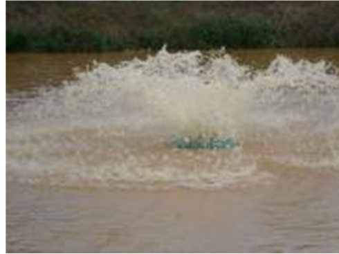
Figura 4. Aerador Bonkoski em funcionamento
